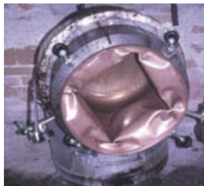
Zerstörtes Brenngerät durch Überdruck
